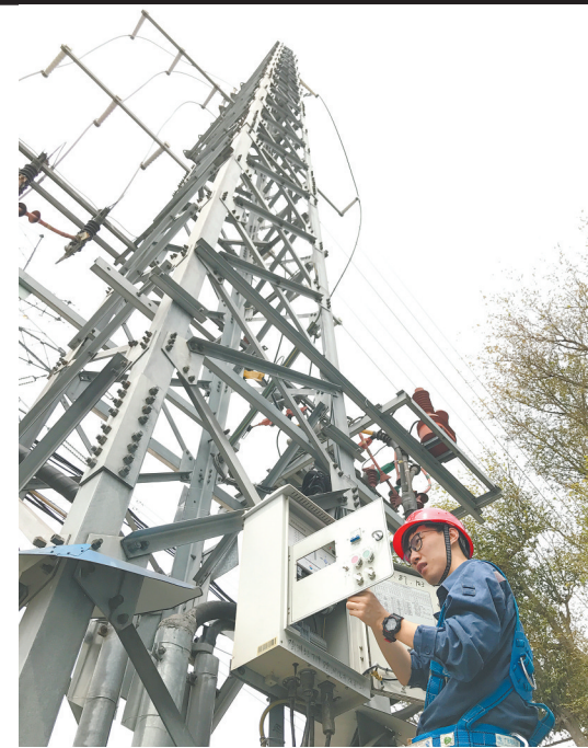
南方电网广东顺德供电局运维人员对自动化开关二次控制器进行维护检查工作
