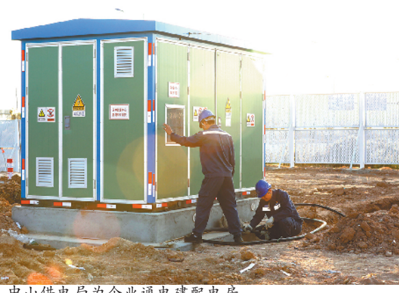
中山供电局为企业通建设配电房
