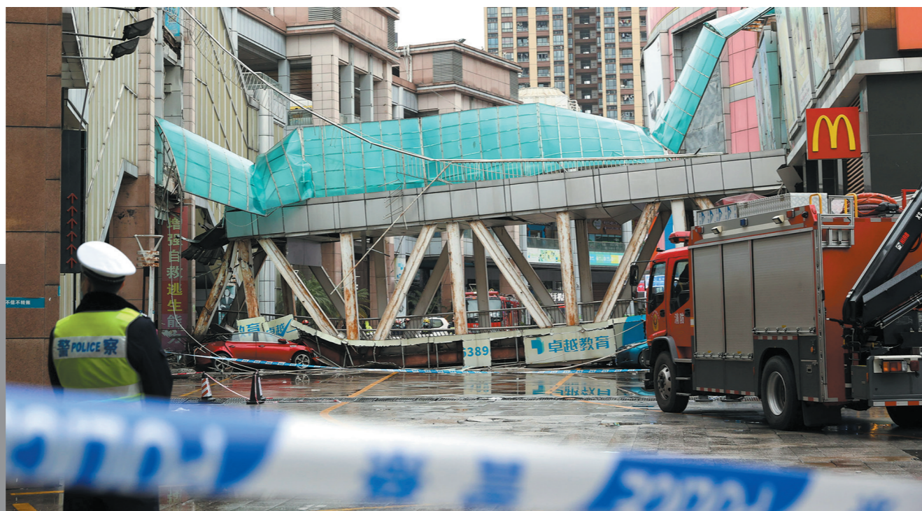
2月21日下午,东莞世博广场双层人行天桥坍塌,造成车辆受损
