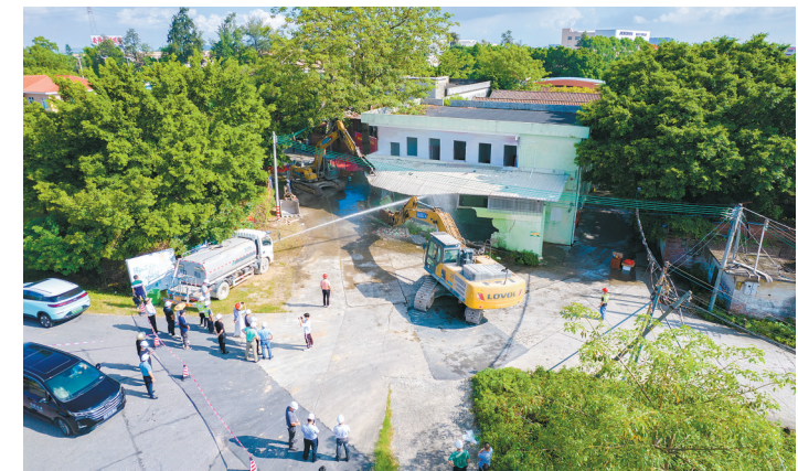
顺德区、均安镇两级清岸执法组,鹤峰社区和南沙社区联合开展清岸行动
