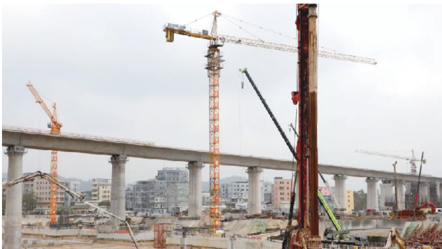
东莞危大工程管理系统可以加强对基坑、脚手架、建筑起重机械、高支模等关键环节的管理
