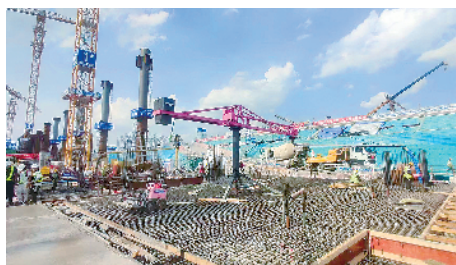
全国首批试用智能化建造机器人的铁路站房建设项目——广州白云站智能建造
