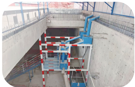
超高泵送系统下地下室：在控制扬尘的同时大幅度降低了泵车泵送时的噪音
