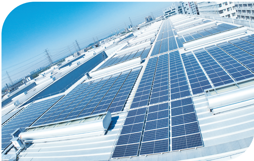
申菱环境高新区智造基地研发大楼引入光伏光热等清洁能源
