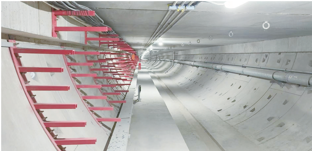
广州城区地下综合管廊下舱 唐培峰 摄
