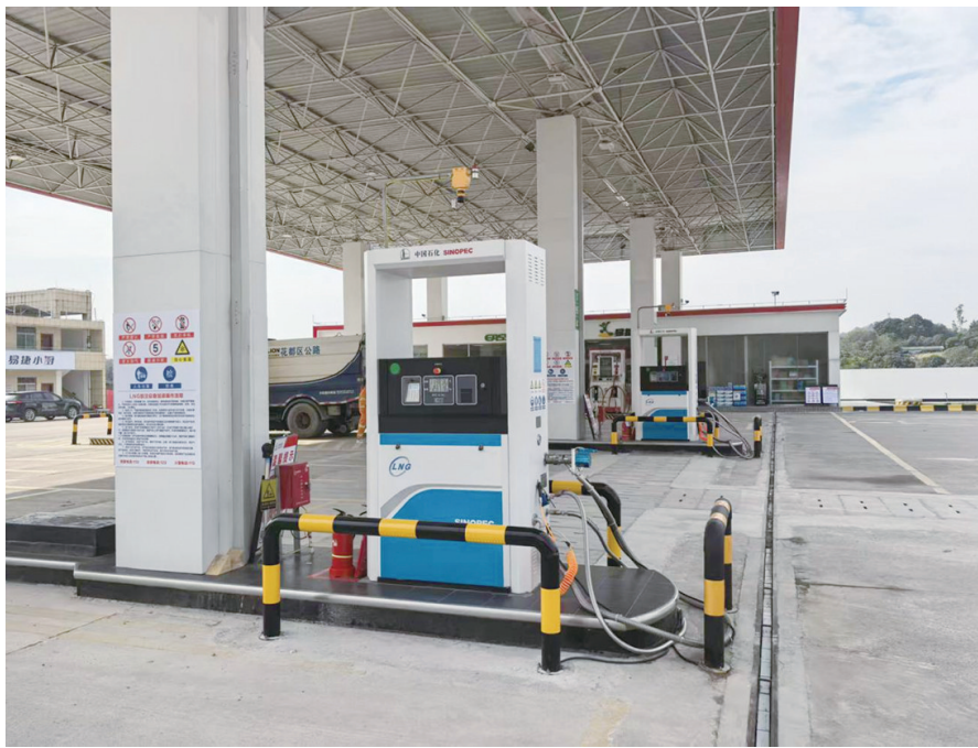
LNG加气站内的加气设备（广州市城管局供图）
