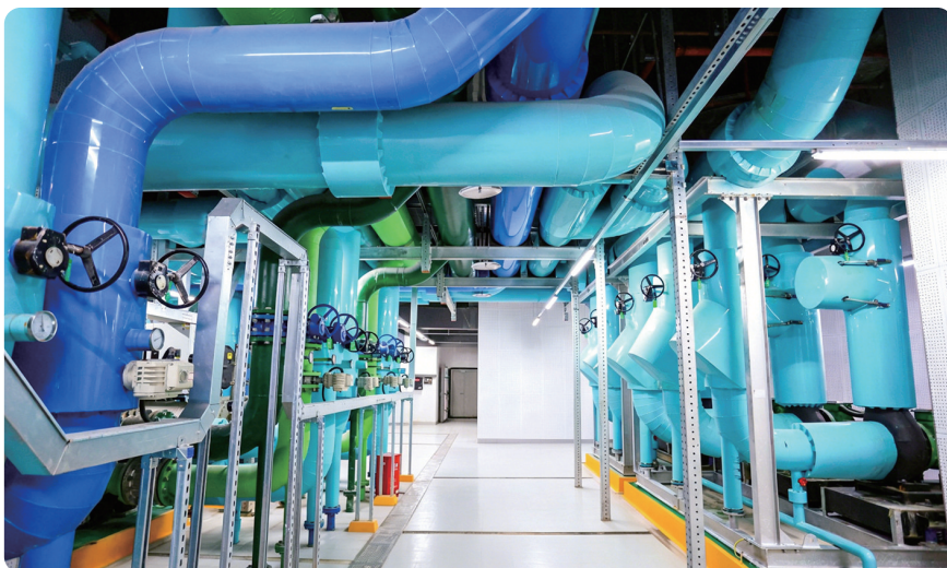
联润大厦模块化智能热控机房
