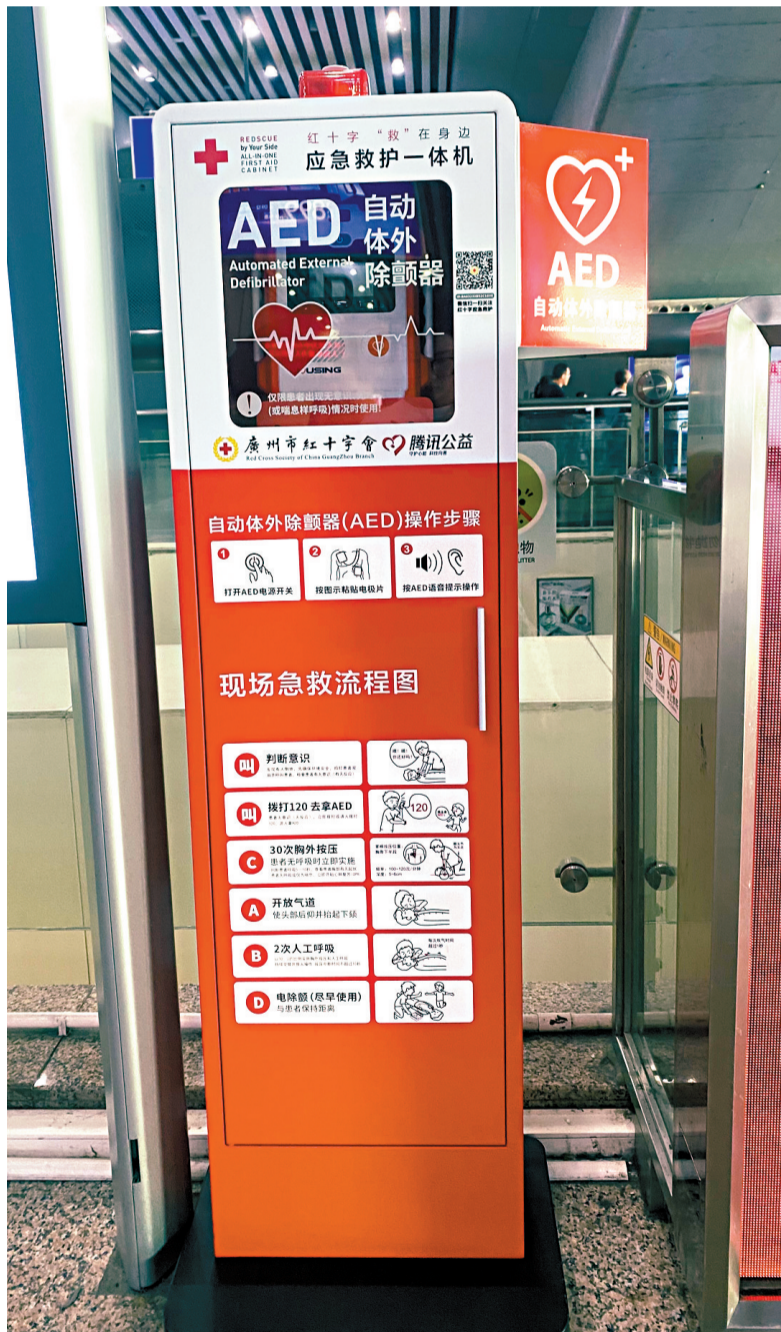
■广州南站一层西北验证口人工服务台右侧配置了一台AED。新快报记者 毛毛雨/摄
