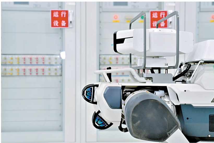
■机器狗“吠云”开展设备巡检工作。
