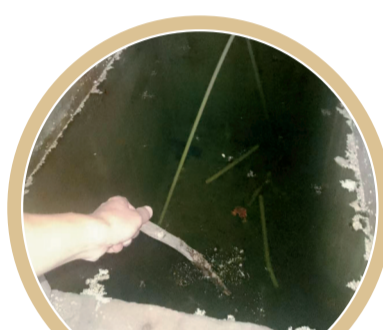
■业主称地下室有两处空置区域注满了水,且完全没遮挡。
