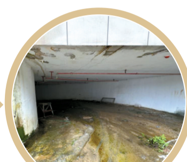
■悦山居小区部分地下车库潮湿发霉,杂草丛生。
