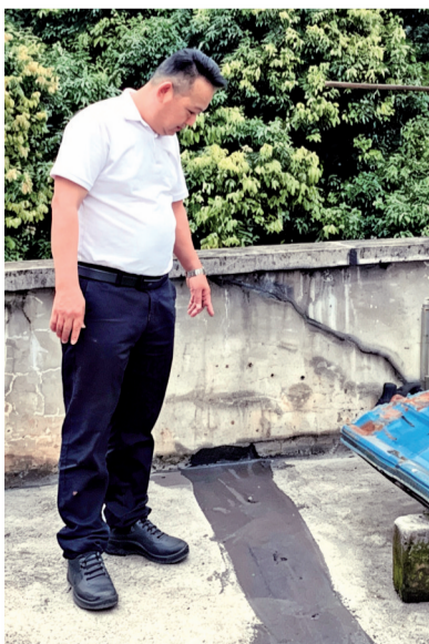
■居民钟于文指着他家屋顶曾经的开裂处,如今已经被修缮。新快报记者 罗琼/摄
