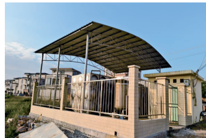
■高田村新增过滤塔后,村民喝上了放心水。
