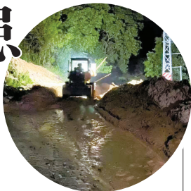
■山体滑坡后揭西县上砂镇汤峯村村道堆满淤泥,铲车铲出临时通道。
