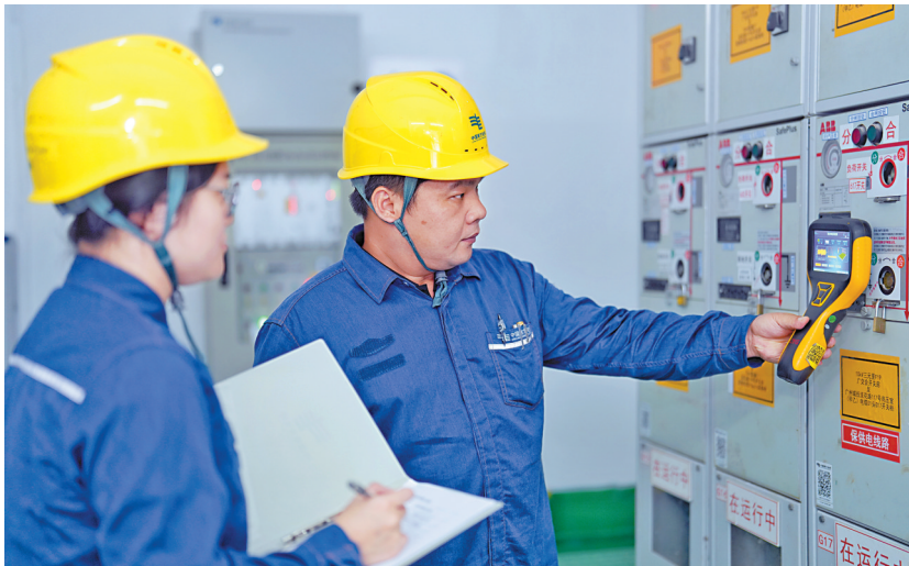
■张桂凯(右)与同事在流花路展馆检查供电设备。
