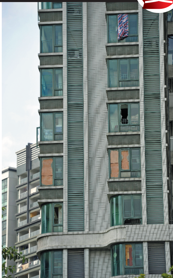
遇台风天,老旧玻璃窗尤易爆裂坠落(资料图片) 视觉中国供图
