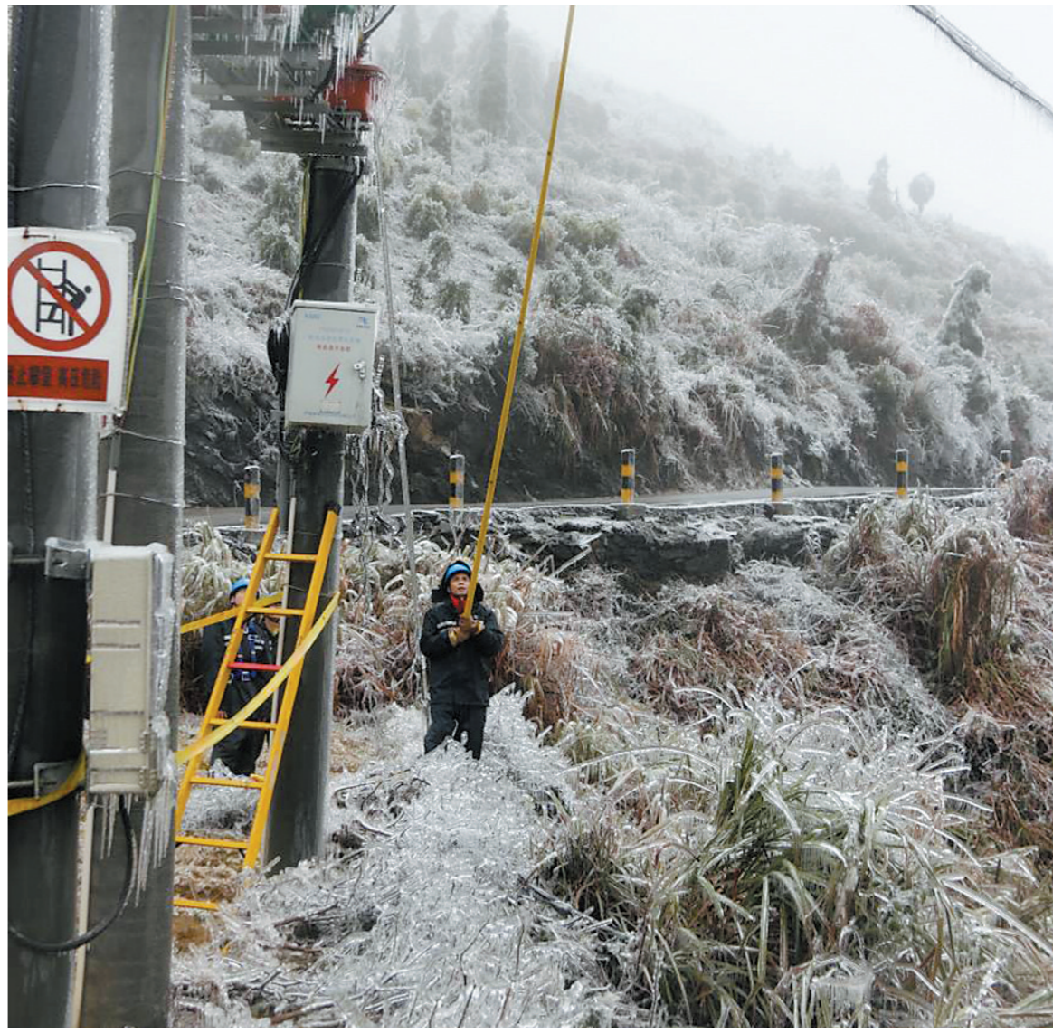
2022年2月20日前后，乐昌市供电局抢修人员正在抢修复电 刘尉斌 摄
