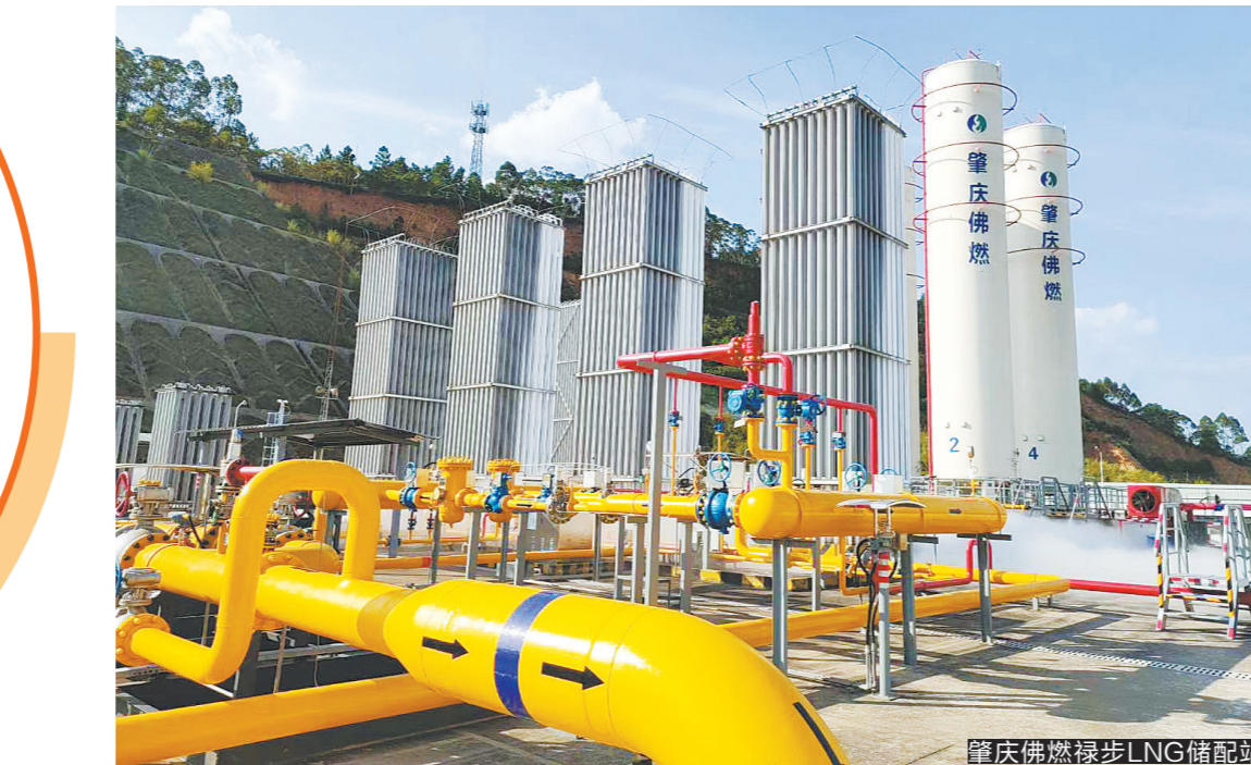
肇庆佛燃LNG储配站
