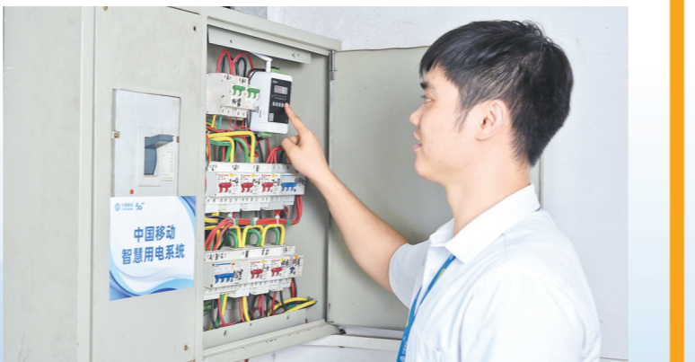
工作人员操作智慧用电系统
