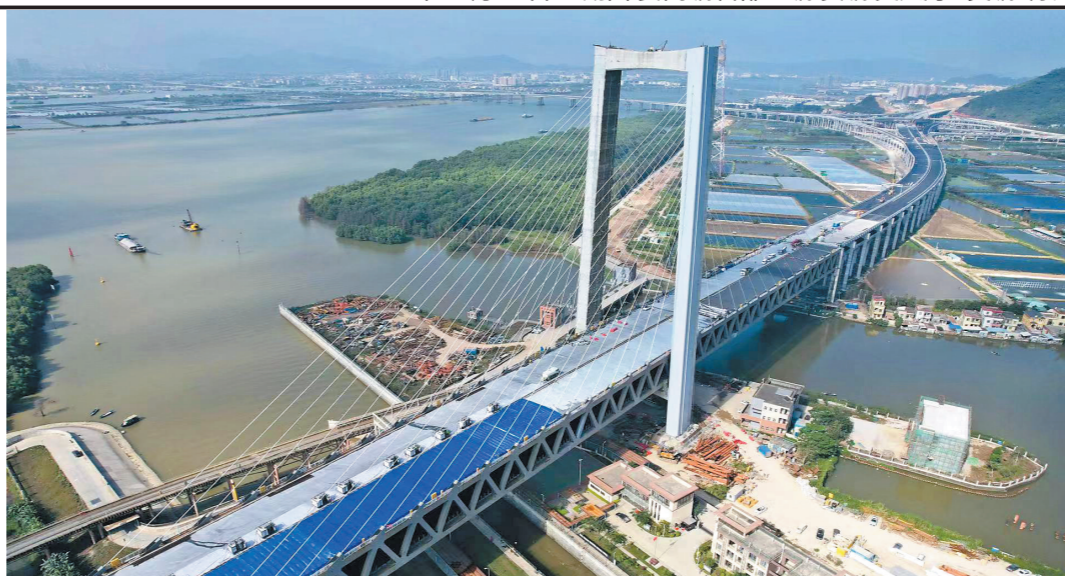
广东省重点项目中山西环高速公路联络石湾钢桥面施工现场
