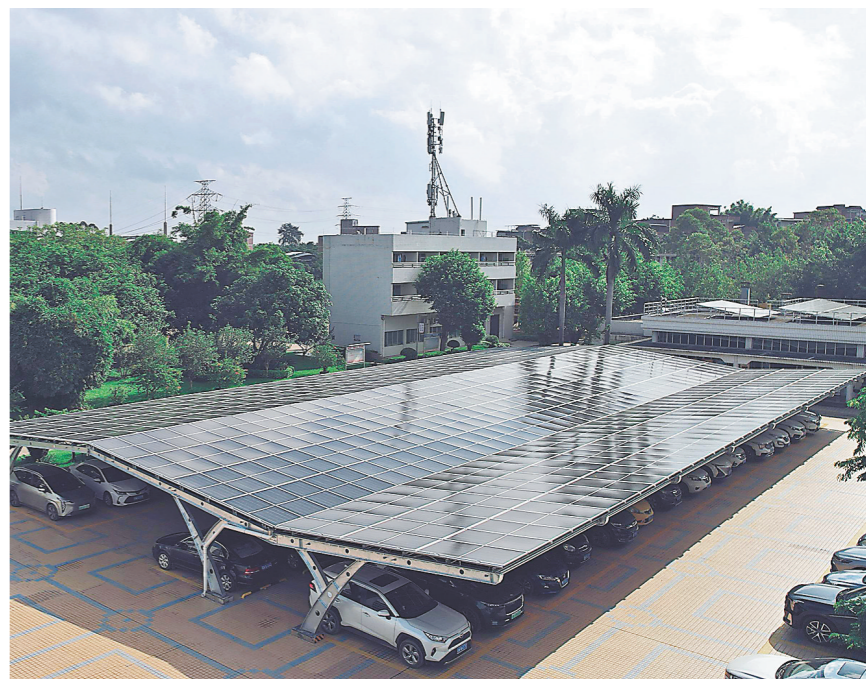
粤流发电公司屋面分布式光伏项目
