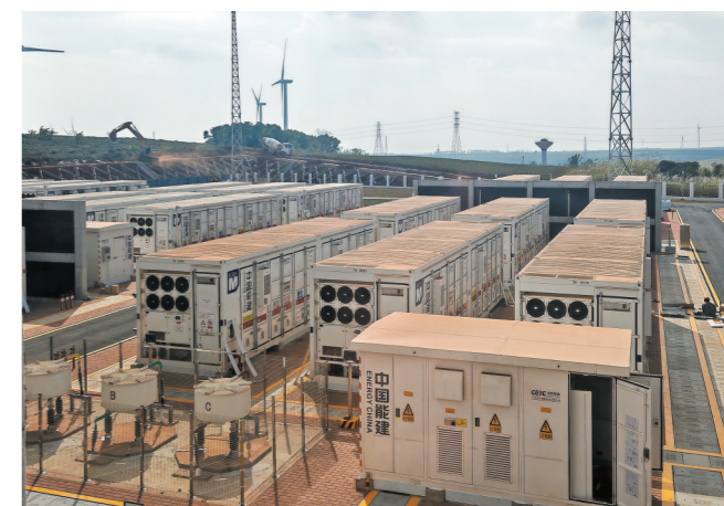
图为广东省首个接入大规模海上风电并网的独立储能项目，将有效缓解电网运行压力，保障电力系统安全
