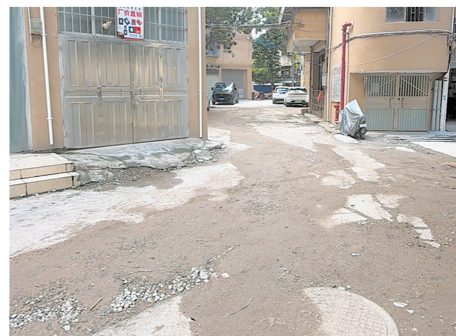
小区地面坑洼洼洼
