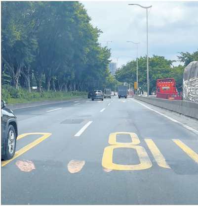
路面上新旧交替的沥青修补痕迹
