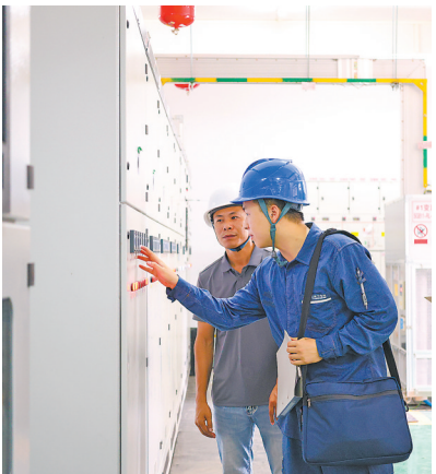
南方电网广东中山小榄供电分局客户经理到“工改”园区开展用电检查
