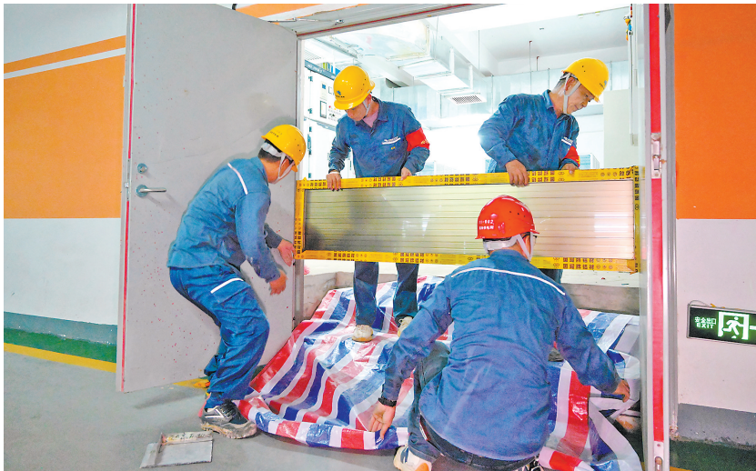
供电局工作人员在配电房出入口架设防洪挡板、堆叠防汛沙袋 通讯员供图
