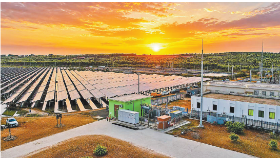
湛江35千伏马留台区变顺利投产
