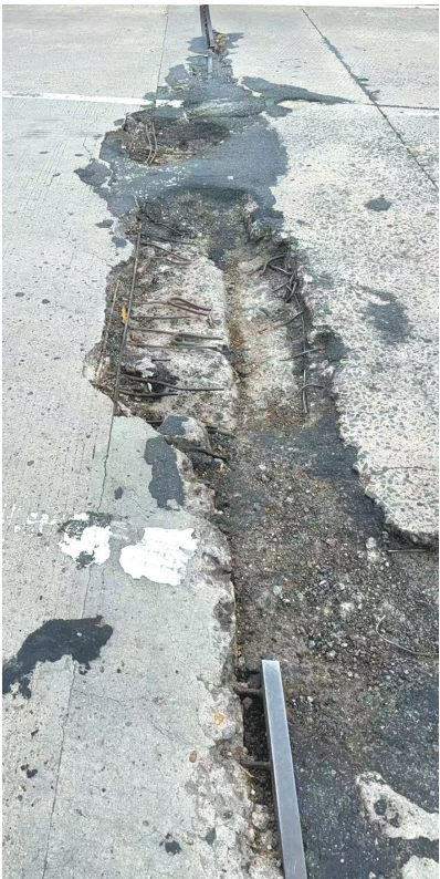
该路段此前路面破损、钢筋裸露 受访者供图
