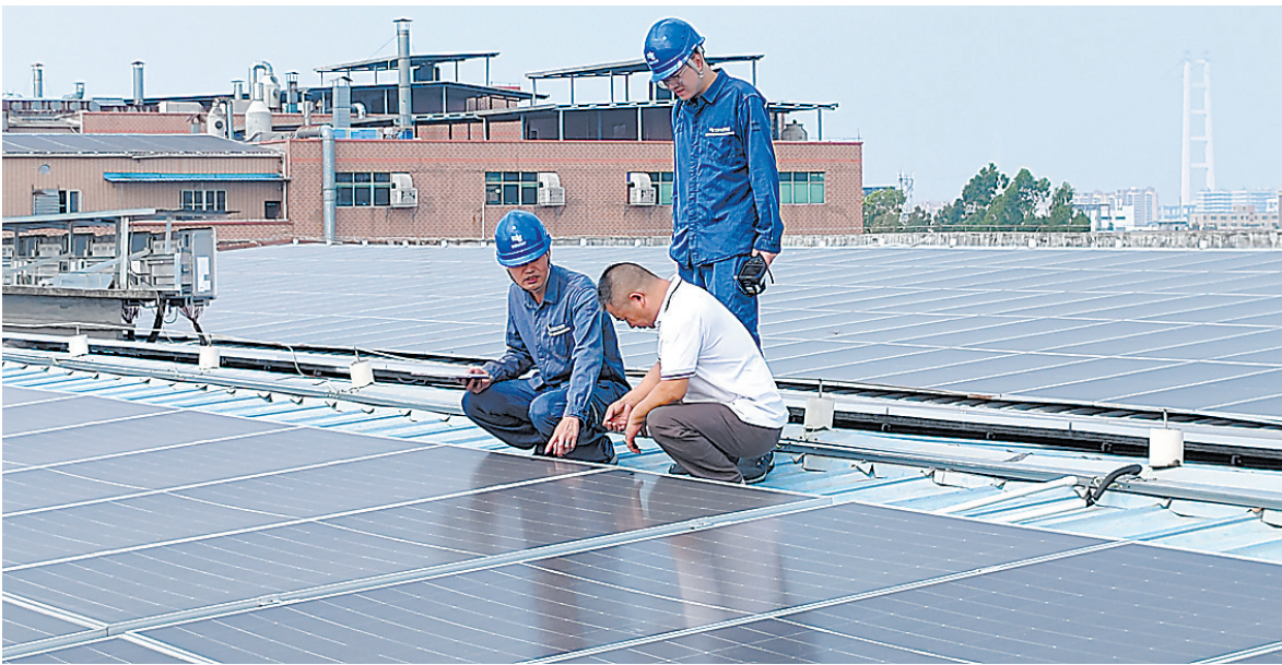
近日,东莞西区供电局工作人员协助企业开展光伏用电设备安全检查,排查消除安全隐患
