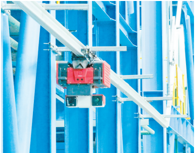
广州环投集团智慧电厂内,轨道式巡检机器人把关安全生产
