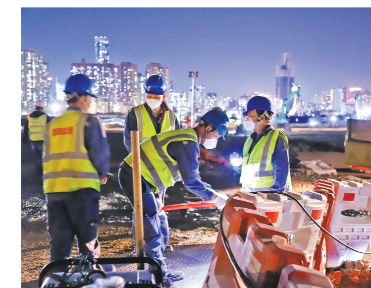
南方电网深圳供电局协调海关等部门，顺利完成送电 黄志伟 摄
