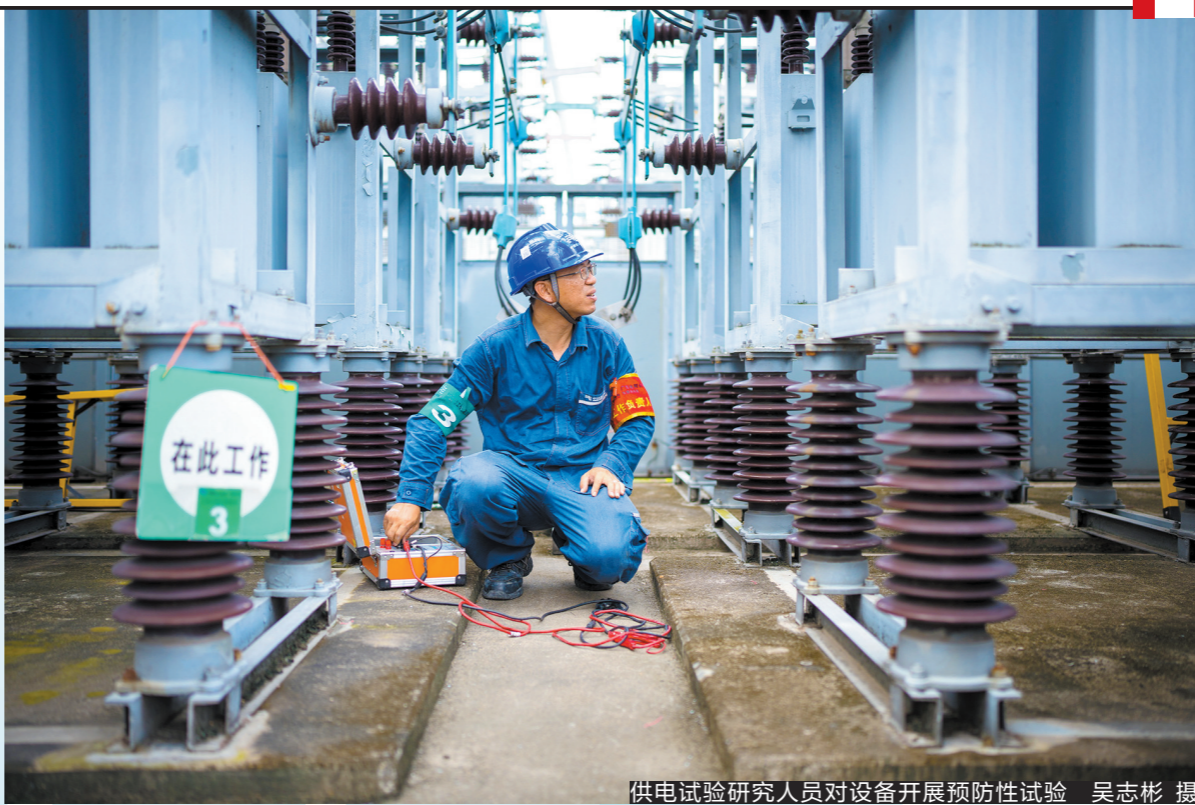
供电试验研究人员对设备开展预防性试验 吴志彬 摄
