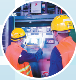
供电人员开展全面夜巡,监测设备状态 刘锦波 摄
