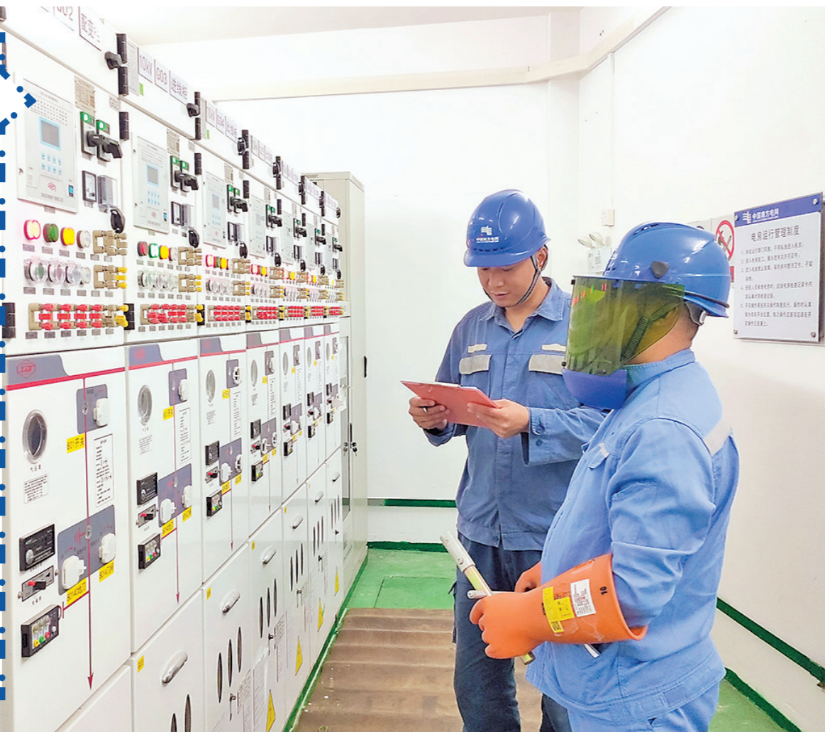
南方电网广东佛山南海供电局狮山供电所工作人员在新建公用开关站内核对相关设备名称、编号及位置 麦建志 摄
